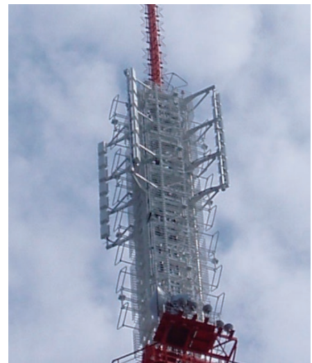
図3 スキューアンテナ全景
